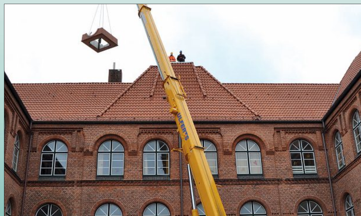
Passgenau wurden die einzelnen Teile des Uhrenturms der Grundschule im Juni 2012 aufgesetzt. FOTO: LEIDIG
