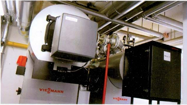
Brennwert-Kesselanlagen mit Brenner-Schalldämmhauben
