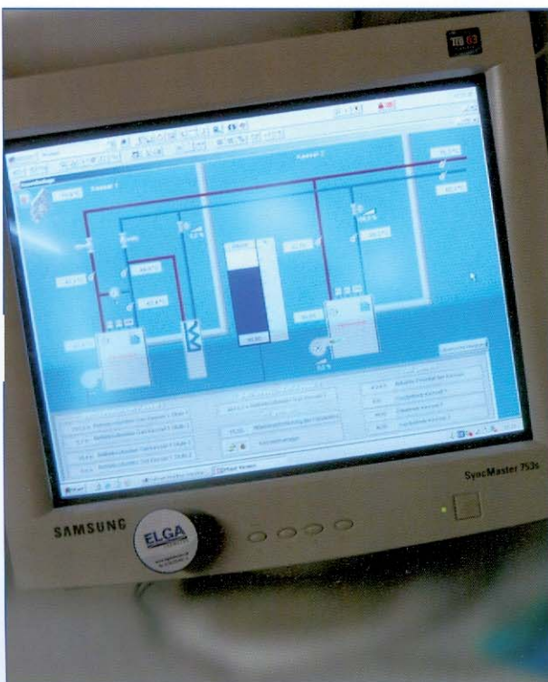
Computeranlage der Gebäudeleittechnik
