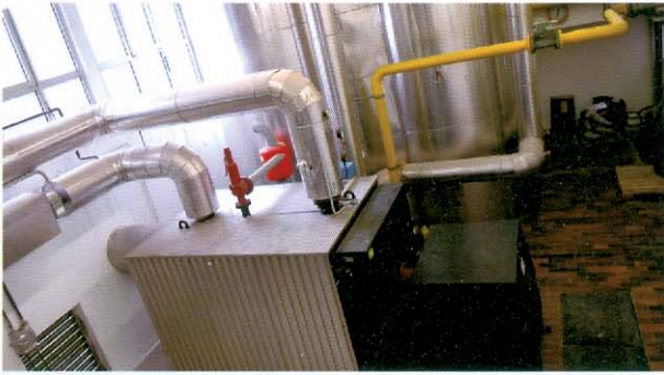
Größter Heizkessel auf Norderney mit 2000 kW Heizleistung
