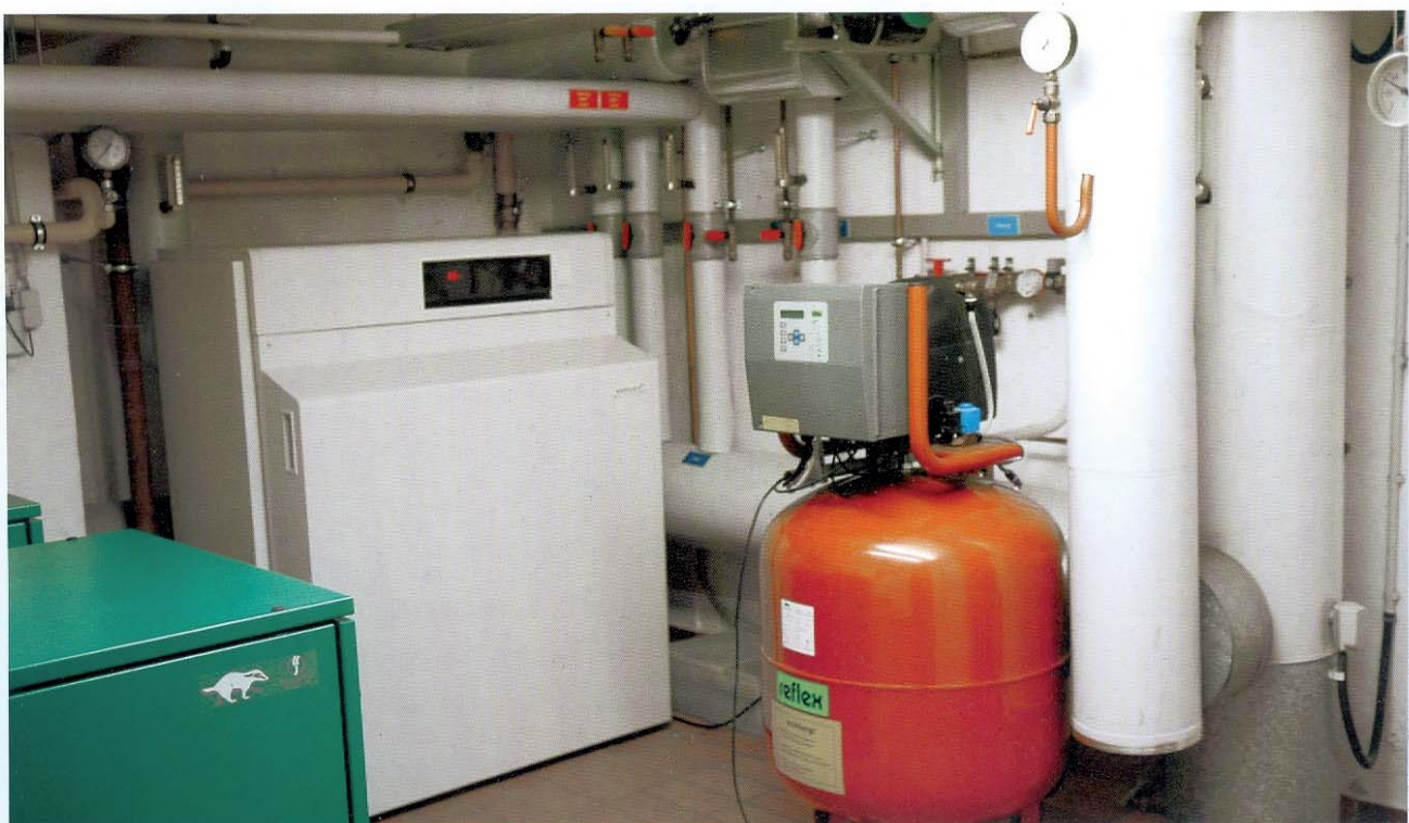
Klein-BHKW mit Brennwertkessel und Druckbaltestation
