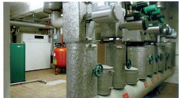
Heizkessel mit Heizungsverteiler
