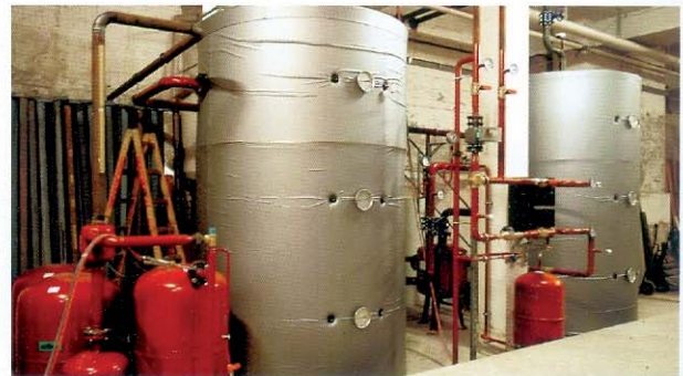
Pufferspeicher Solaranlage mit Druckbaltestation
