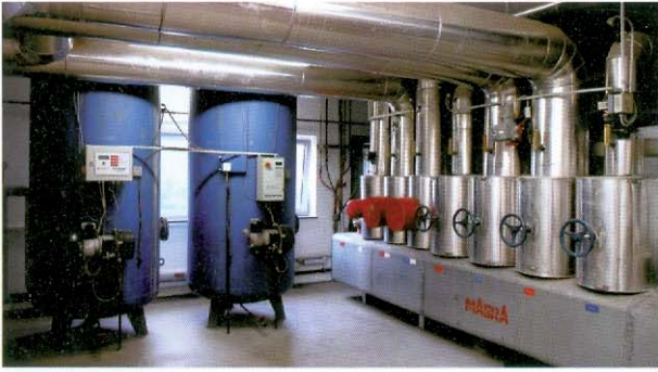
Druckhaltestation mit Heizungshauptverteiler für die Versorgung des Nahwärmenetzes
