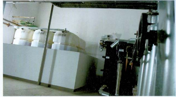
Öltankanlage für Zweistoff-Brenner und Notstromaggregat
