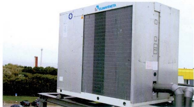
Wasserkühlmaschine als Dachkompaktzentrale
