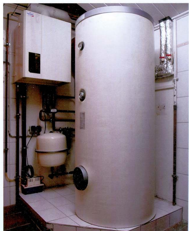
Brennwertheizkessel mit bivalentem Brauchwasserbereiter
