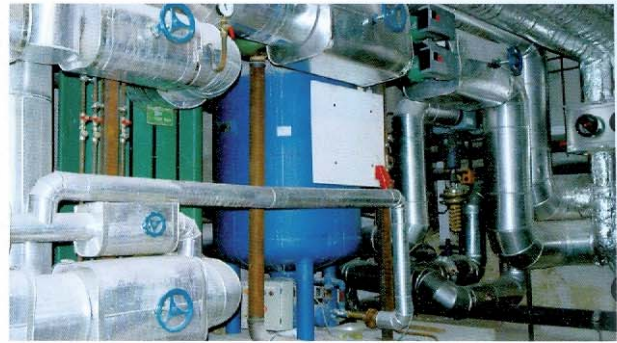
Übergabestation von der Fernwärme
