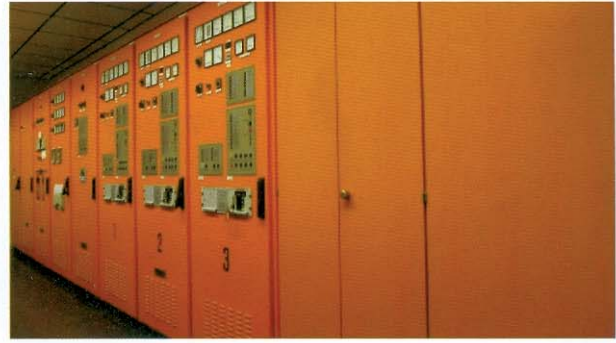
Schaltschrankanlage mit Gebäudeleittechnik
