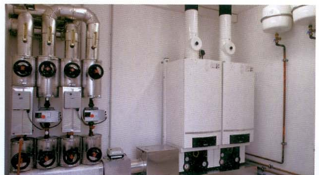
Regelverteiler mit Brennwertkessel-Kaskade
