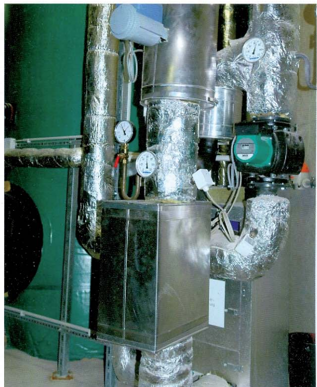
Regelstation mit Speicher für die Seewassererwärmung zur Versorgung der Brauchwasserduschen
