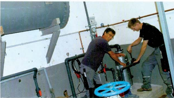
Vakuumpumpenanlage für die Seewasserversorgung der "Welle-Thalassobad" und der Kurklinik
