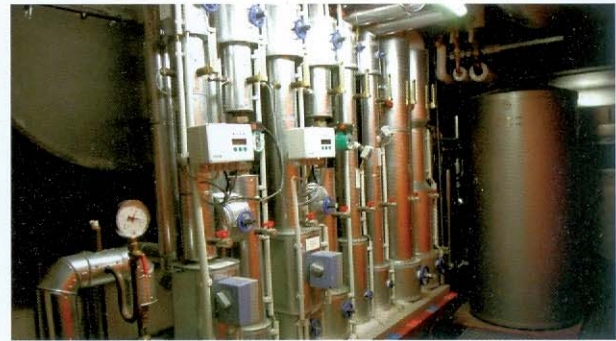
Unterverteilung Neubau von der Nahwärmeversorgung
