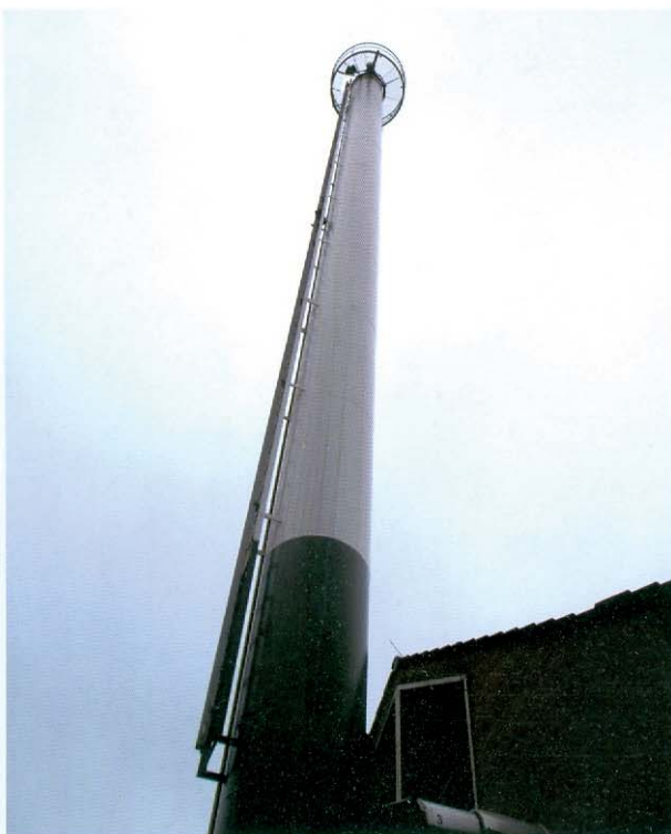
Abgasschornsteinanlage der BHKW-Module am Weststrand
