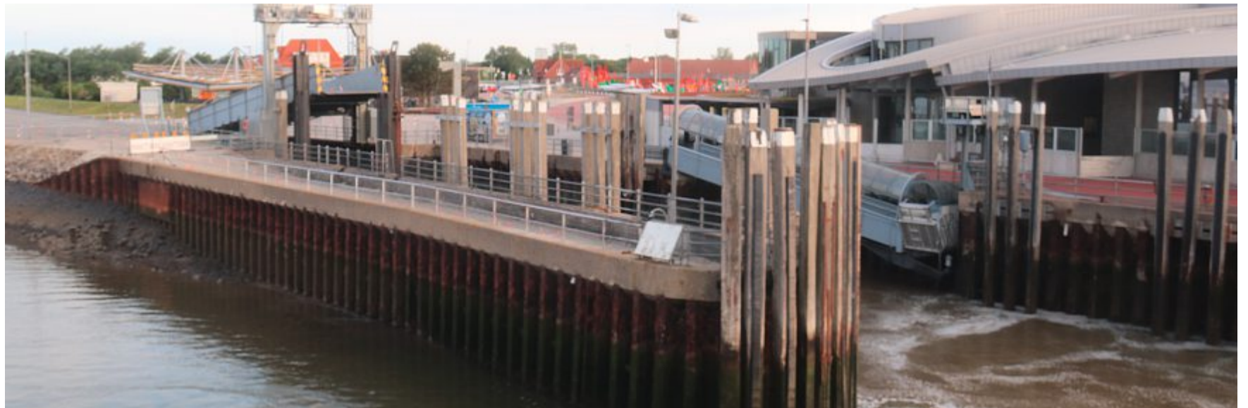
Der Abriss der maroden Mole folgt ab 15. April.
