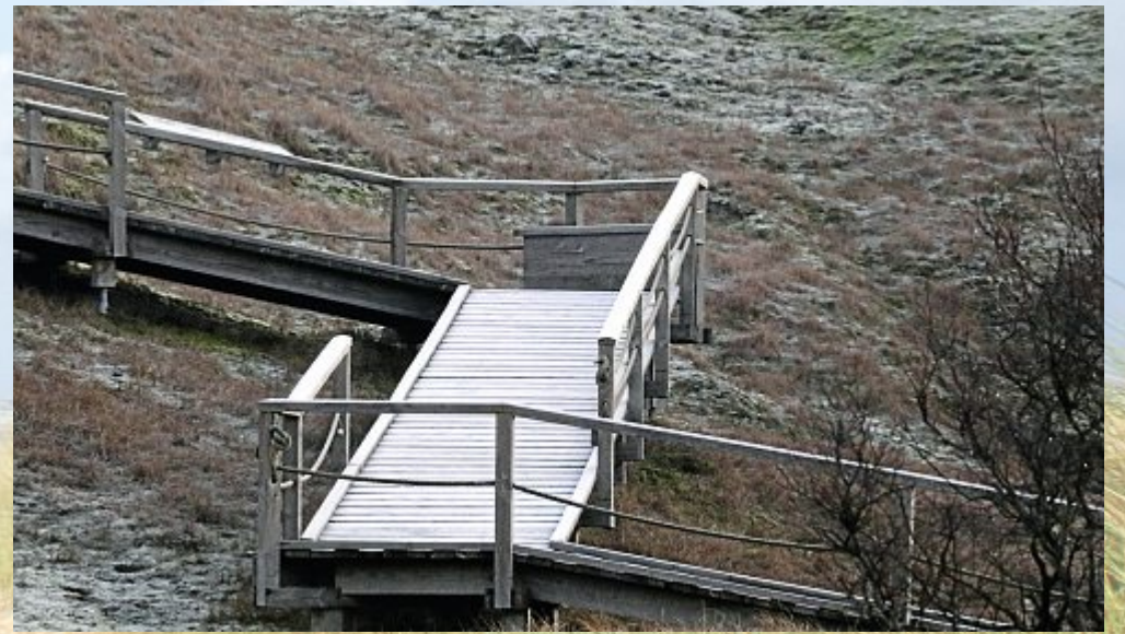
Thalassoweg auf die Thalassoplatform am Dünensender - Vorsicht Rutschgefahr.
