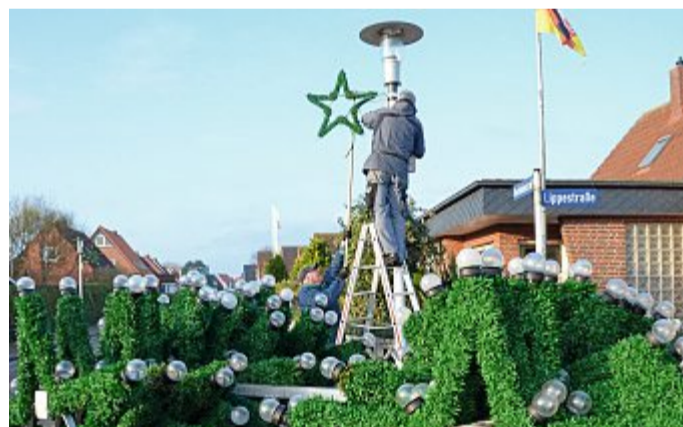
Wieder Weihnachtsbeleuchtung in der Nordhelmsiedlung – nur kürzer. Los geht es am 26. November.
