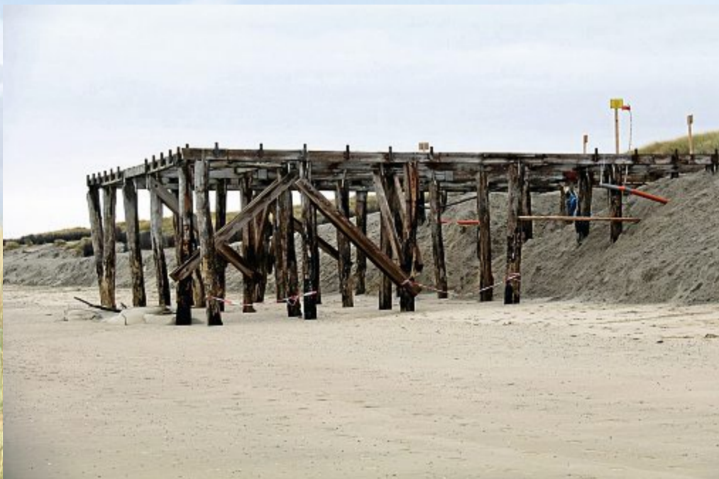
Abbruchreif. Die Konstruktion an der Weißen Düne wird erneuert.
