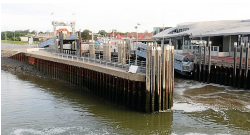
So sieht der Ist-Zustand aus. Die Kampfmitteluntersuchungen sind bereits abgeschlossen. Foto: Noun
