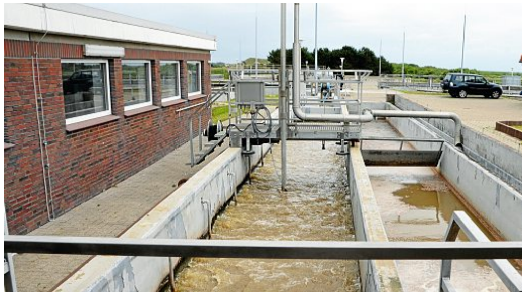
Fett- und Sandfang der Kläranlage Norderney.
