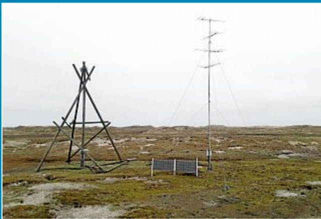
Auf Norderney wird Forschung vorangetrieben: Weitere Sendemasten sind aufgestellt worden.
