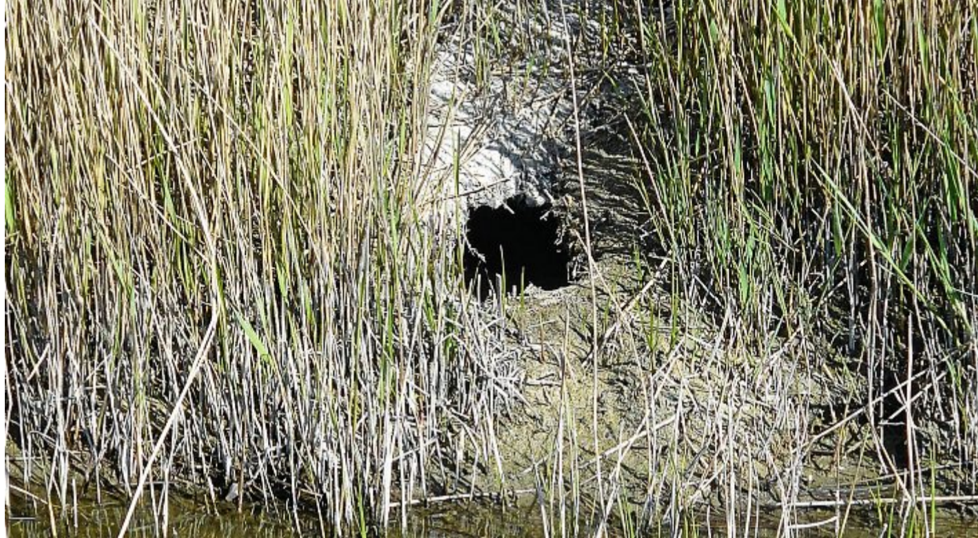
Gefährliche Schwachstelle im Deich: der Eingang zu einem Nutriabau im Außendeichringgraben.
