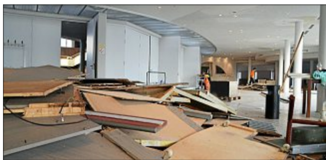
Derzeit wird das Haus der Insel, das Anfang 2020 abgerissen werden soll, ausgeräumt. FOTO: DIERCKS
