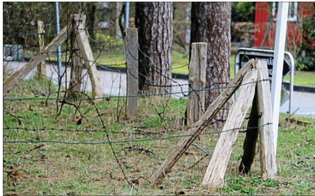
Gegen das unschöne Bild mit kaputten Stacheldrahtzäunen im Ruppertsburger Wäldchen will die Stadt nun vorgehen. FOTO: NOUN
