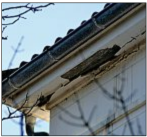
An einigen Stellen sind die Gesimskästen schadhaft.
