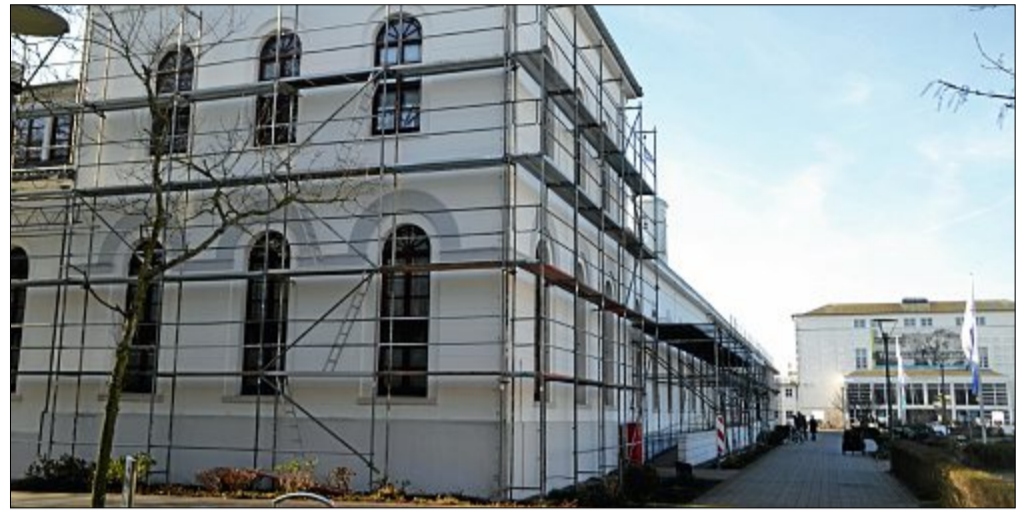
Zurzeit stehen Gerüste an Ost- und Nordseite des Gebäudes. Die anderen Seiten folgen später.
