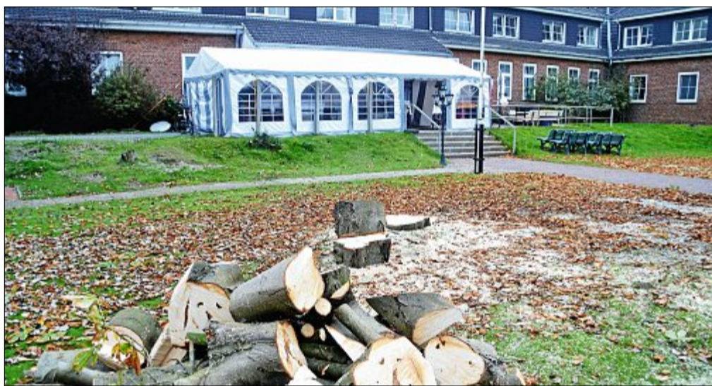
Ein kahles Bild präsentiert sich nun auf der Fläche vor dem Seniorenzentrum To Huus. Am Montag hatten die Rodungsarbeiten begonnen.
