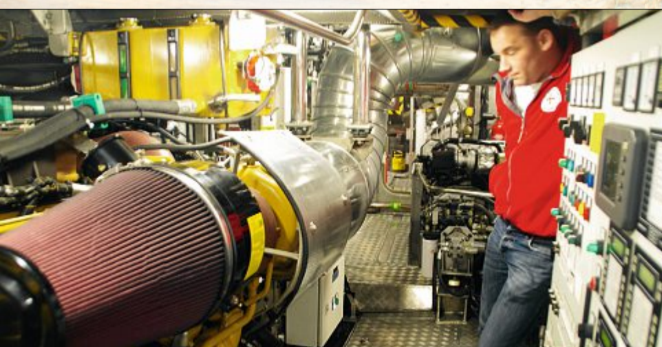
Heiko Erdwiens im Maschinenraum der „Eugen“. Es glänzt und blitzt.
