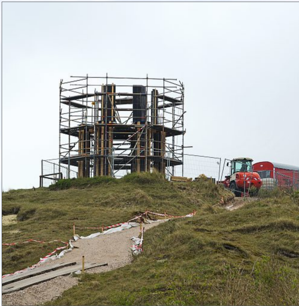
Futuristisch mutet zurzeit das Kap an. Wenn der Betonkern fertiggestellt ist, werden auf alt gemachte Klinker als Verblender angebracht.
