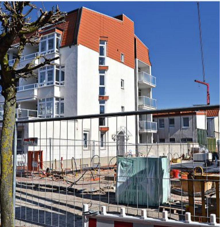
Bei der Baustelle in der Winterstraße 19 ging es einige Zeit nicht voran. Jetzt wird wieder gebaut.
