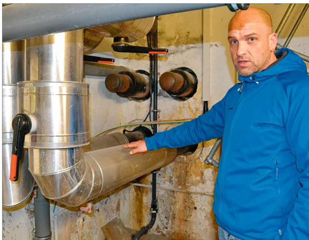
Der Technische Betriebsleiter der Stadtwerke Norderney, Dipl.-Ing. Ingo Lübben, zeigt auf die Vorlauf- und Rücklaufleitungen, die das Bademuseum mit Fernwärme versorgen. FOTOS: RASS
