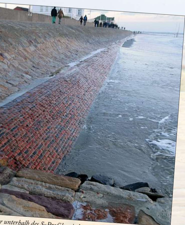
unterhalb des S-Profiles wieder sichtbar.
