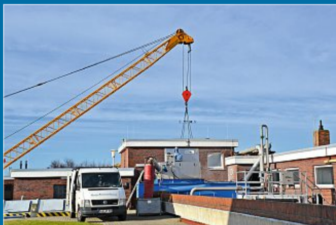
TECHNIK Alte Anlage war 32 Jahre im Einsatz
