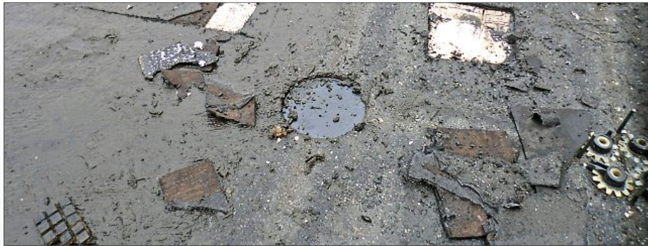
Beispiel für eine sanierungsbedürftige Flachdachfläche. Das Team um Malte Eberhardt weiß, was zu tun ist.
