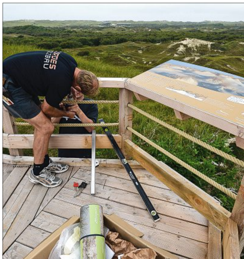
Die letzten Arbeiten am Dünen sender: Die Informationstafeln und Spielgeräte sind ein wesentlicher Bestandteil des Plattformenkonzepts.
