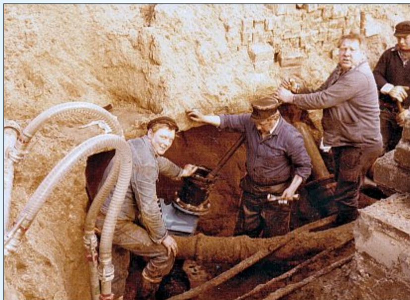
Ausbau der Wasserleitungen: Der Grundstein für eine flächendeckende Versorgung wurde auf der Insel schon früh gelegt.
