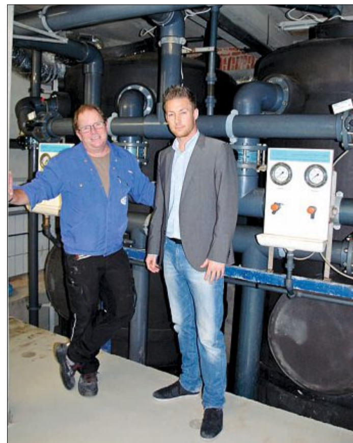
Im Keller des Badehauses: Jürgen Rass (links) und Eike Rass zeigen die Filteranlage, die mit neuem Kies bestückt wurde.
