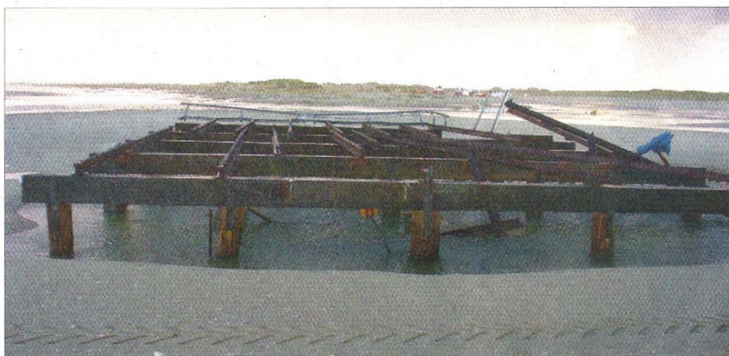
Lediglich das Pfahlrost der Containerplattform bleibt nach dem Sturm „Britta“ übrig.
