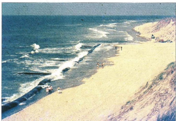
Ein Geweschlauch von 1,70 Metern Durchmesser bremst die Wellen und erlaubt die Fortsetzung der Arbeiten während der Flut. Zusätzlich gibt es Bunnenschläuche. FOTO: SAATHOFF
