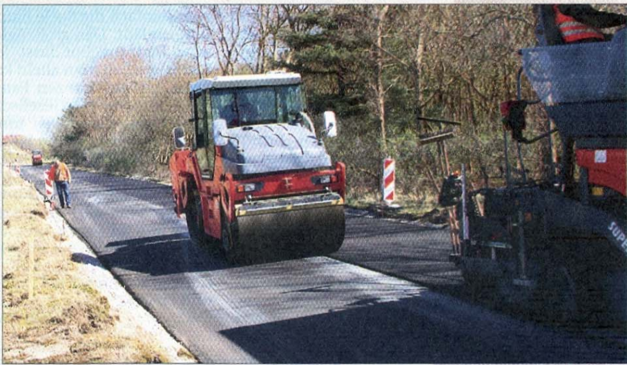
Damit auch alles glatt und eben wird, rollt die Dampfwalze mehrmals auf und ab. Nur kurzzeitig kam es zu einer Komplettsperrung der Straße.
