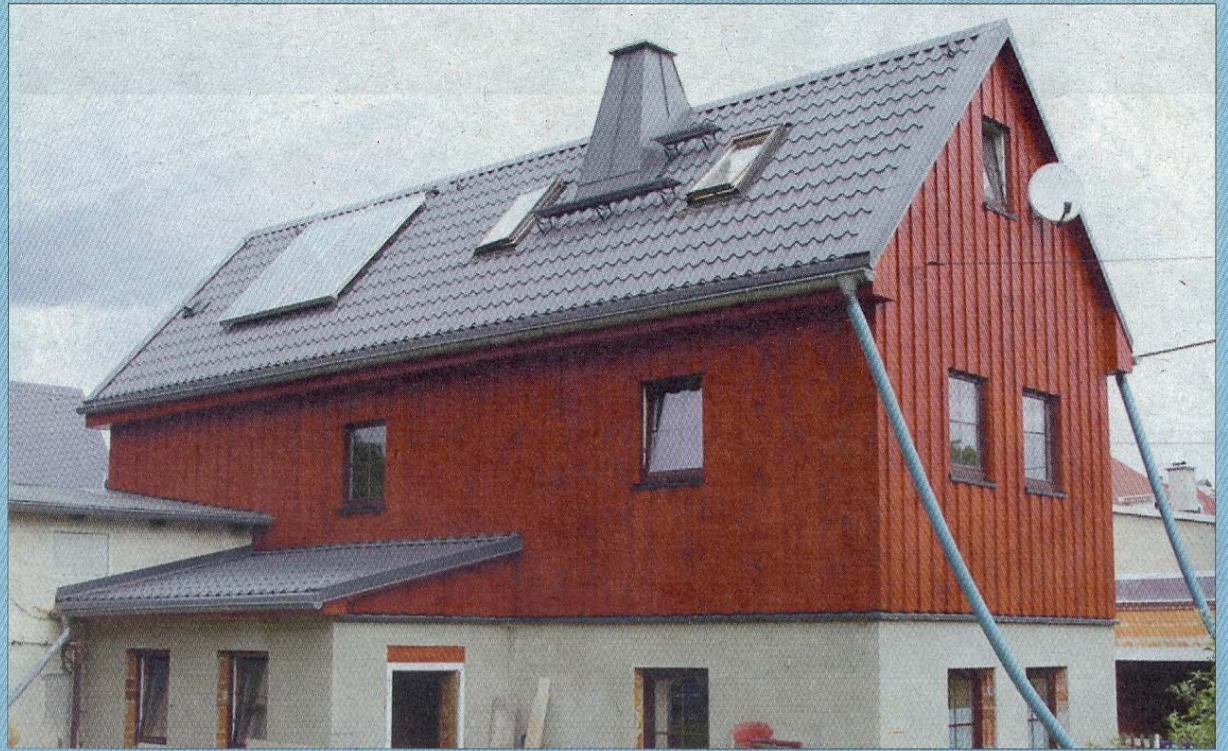
Dachsanierungen sollten rechtzeitig vorgenommen werden.
