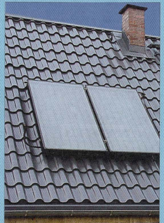
Eindringende Feuchtigkeit kann Schäden verursachen.
