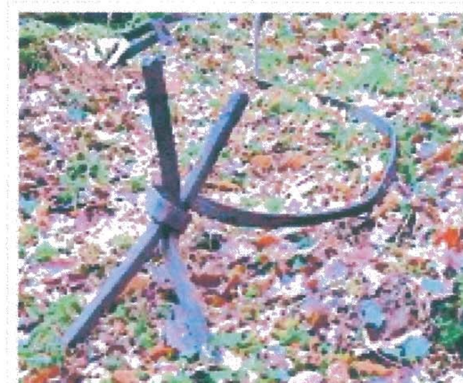
Alter Maueranker mit Bandeisen.
