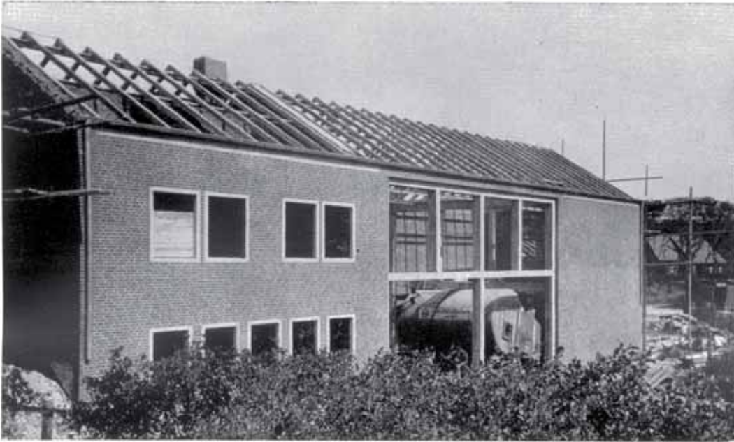
Das neue Maschinenhaus wird sich besser als die bisherige Anlage dem Charakter der Inselandschaft anpassen und später einmal, von Waldungen umgeben, kaum seinen eigentlichen Zweck verraten
